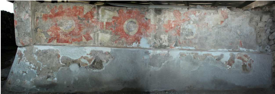
Fachada sur del Edificio 1B', subestructura 2. Se observa la moldura lateral y la ausencia de moldura inferior en el tablero, así como los diseños de la pintura mural.
