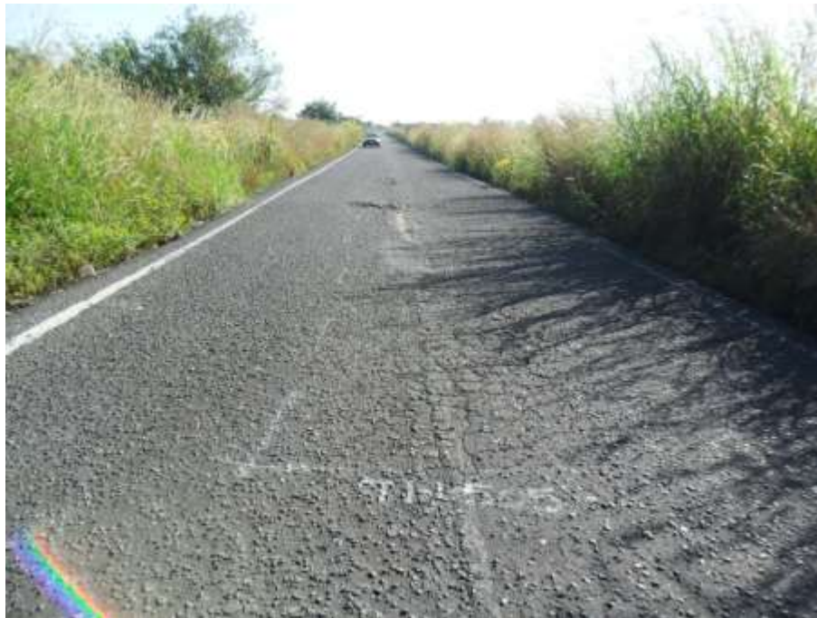
Fig. II. 1 Fallas funcionales y estructurales que presentan el asfalto en el tramo Huatusco-Conejos.
