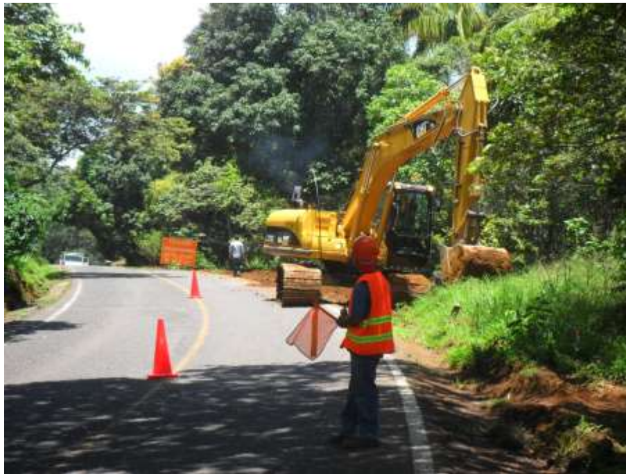
Fig. III. 7 Limpieza del lugar donde se depositaron los volúmenes de tierra del segundo corte.
