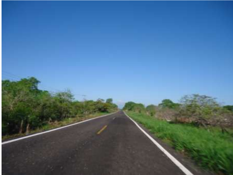
Fig. II. 4 En este kilometraje se presentan mayores deformaciones y fallas estructurales.
