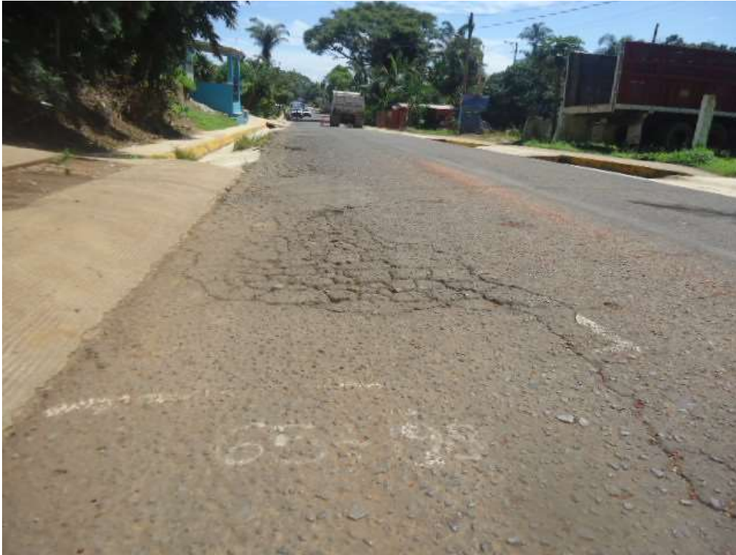
Fig. III. 26 Localización y señalamiento de baches.
