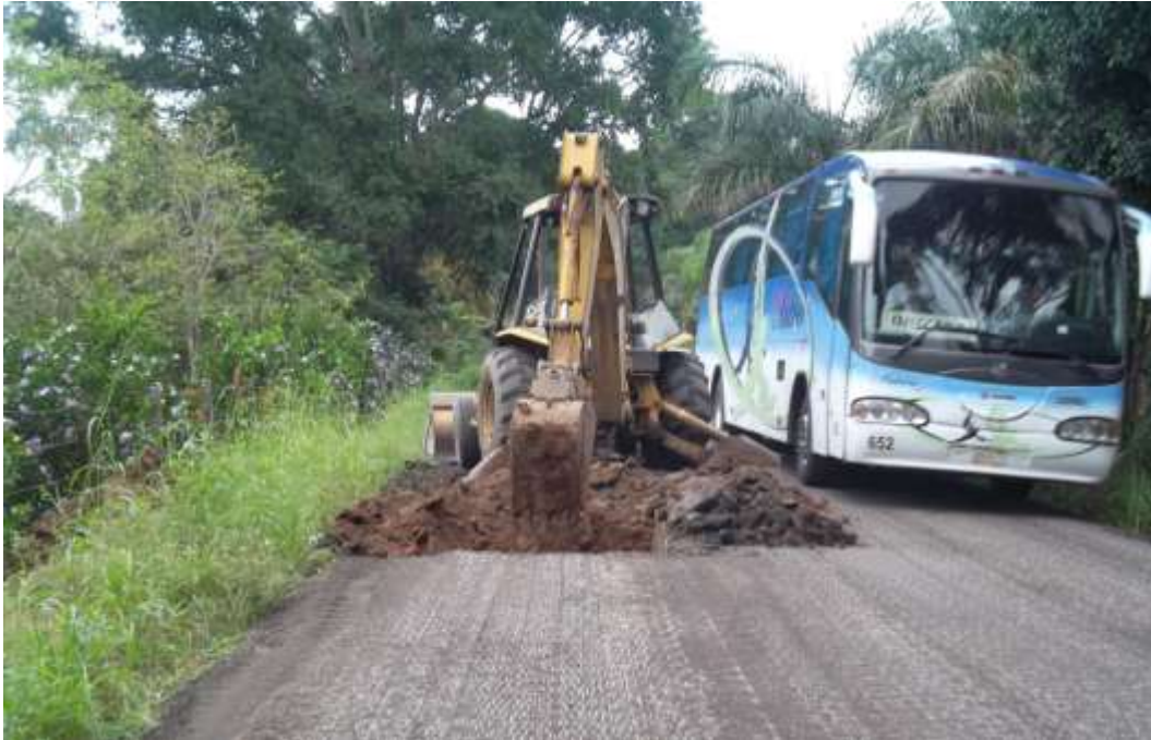
Fig. III. 28 Corte de espesor donde se presentó deformación de pavimento asfáltico.
