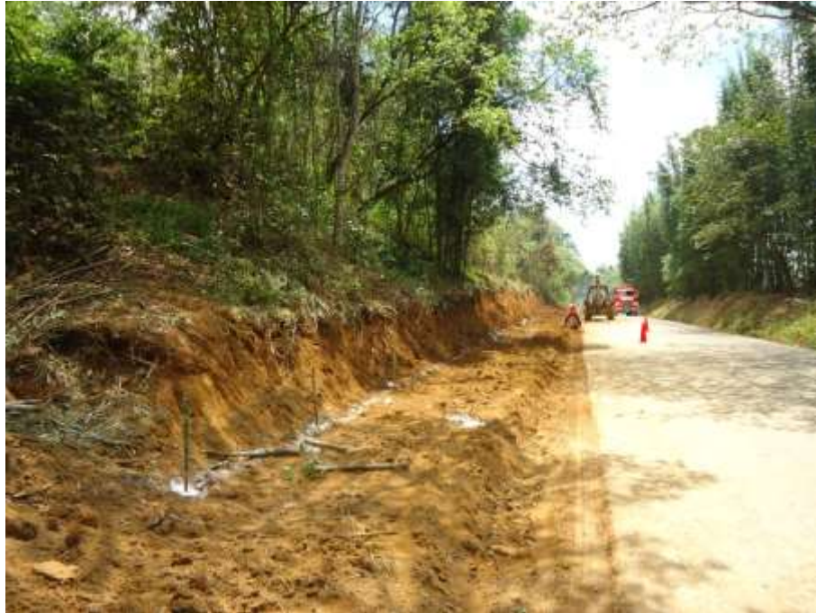
Fig. III. 4 Definición de base para colocación de gaviones y terminación del primer corte en tramo Huatusco-Conejos.
