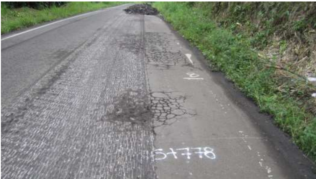
Fig. III. 27 Localización y señalamiento de baches.
