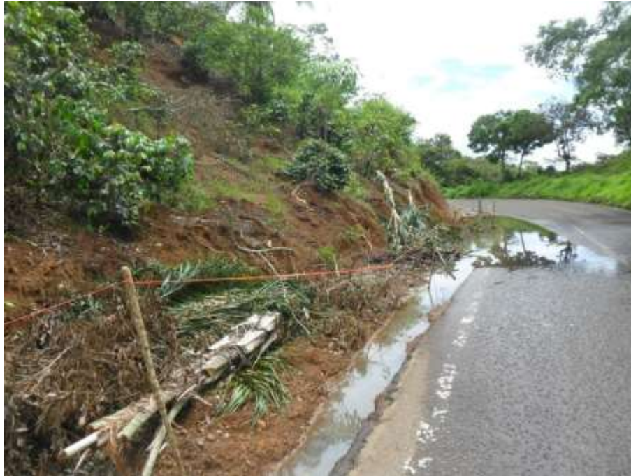
Fig. II. 8 Problemáticas de encharcamiento en zonas de desborde en el tramo Huatusco-Conejos.
