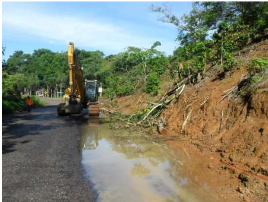
Fig. III. 9 En el segundo corte se presentaron problemas de encharcamiento.
