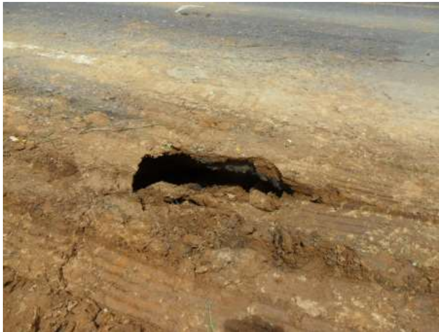
Fig. II. 7 Como se puede observar se tuvo una gran cantidad de problemas tanto en bases hidráulicas como en desgaste del pavimento.
