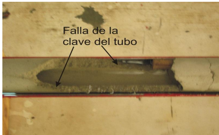
Figura 4.27. Falla del tubo vista en planta.
