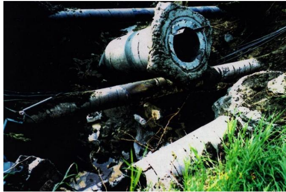
Figura 1.1. Ruptura de la Infraestructura del drenaje de la Ciudad de Edmonton, Canadá.
