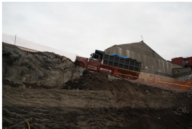
Figura 4.5. Precauciones en el acceso de la excavación.
