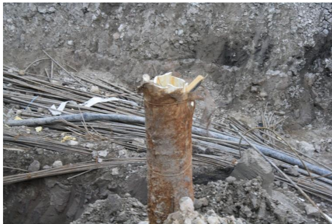
Figura 4.51. Pozo de inspección en condiciones desfavorables.
