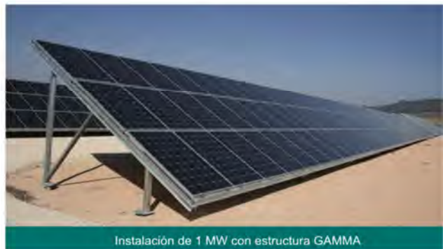
Instalación de 1 MW con estructura GAMMA
