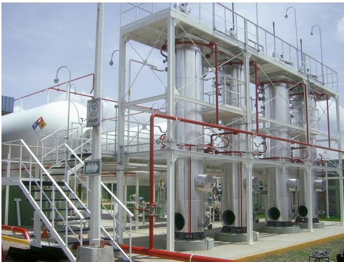
Tren de torres de purificación para propano
