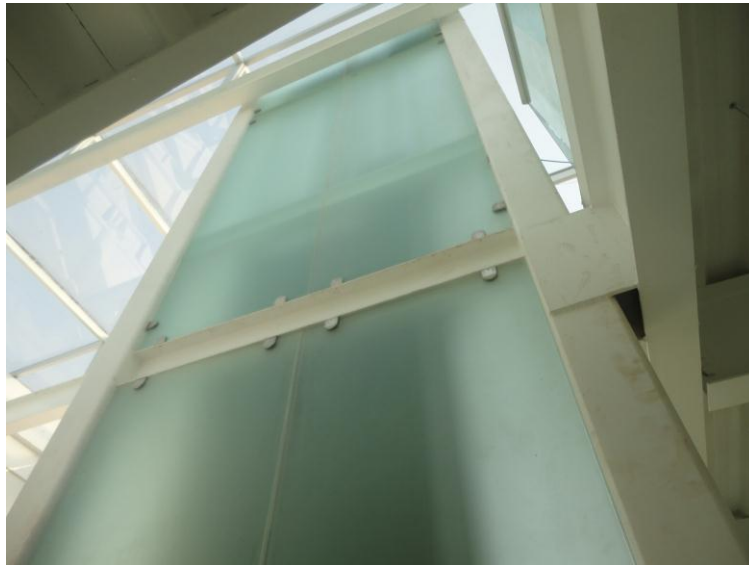
Figura 13.1 Viga donde se acumula el polvo en el elevador.
