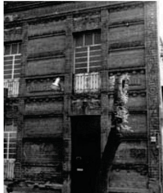
Figura 8.- Casa de tabique aparente, con deterioro relativo. Foto: A. Contreras, 2005.
