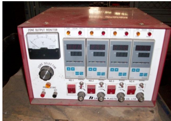
Figura 4.26.- Controlador de temperaturas marca SAN HSIN PLASTIC MOLD CO.
