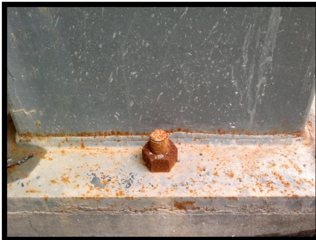
Foto 4.3.- Unión combinada de tornillos y soldadura de placa base a columna principal con soldadura de filete.
