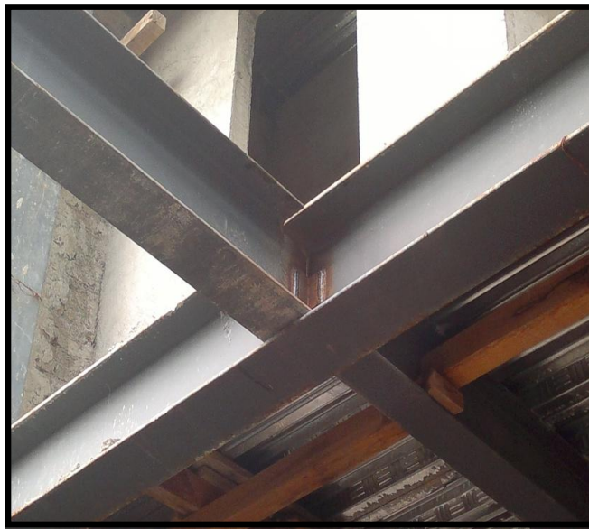
Foto 4.5.- Unión de trabe secundaria al alma de la trabe principal mediante un Angulo y apoyada en el patín inferior.
