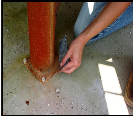
Foto 6.7.- Placa base unida al soporte principal de la escalera.
