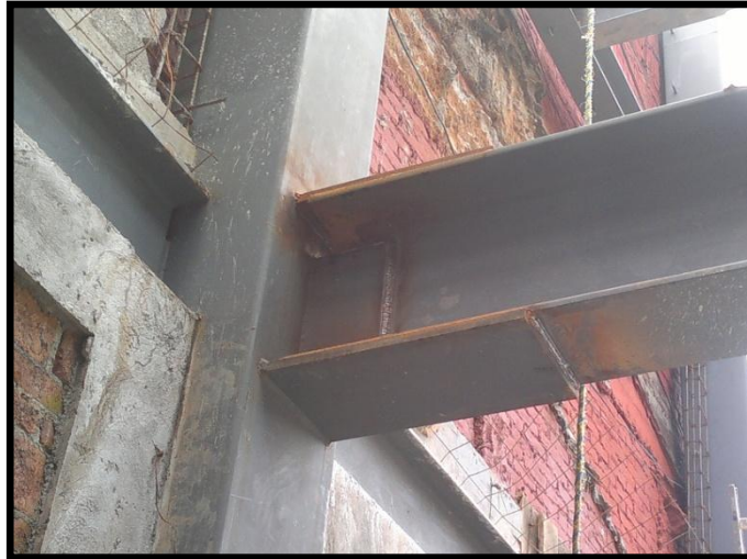
Foto 4.4.- Conexión de trabe y columna principal con placa de apoyo para la trabe.
