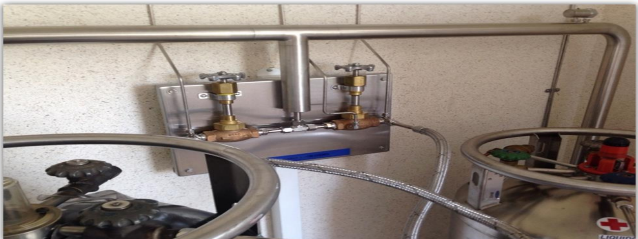
Fig. 16. Válvulas de seguridad en estación de N 2 L
