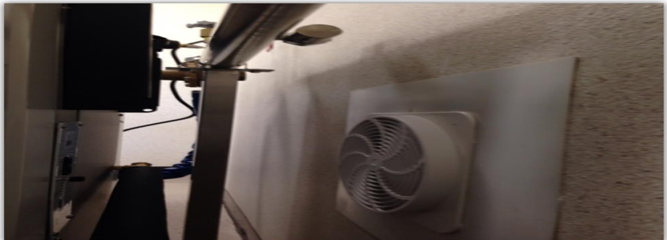
Fig. 13. Sistema de extracción de gases
