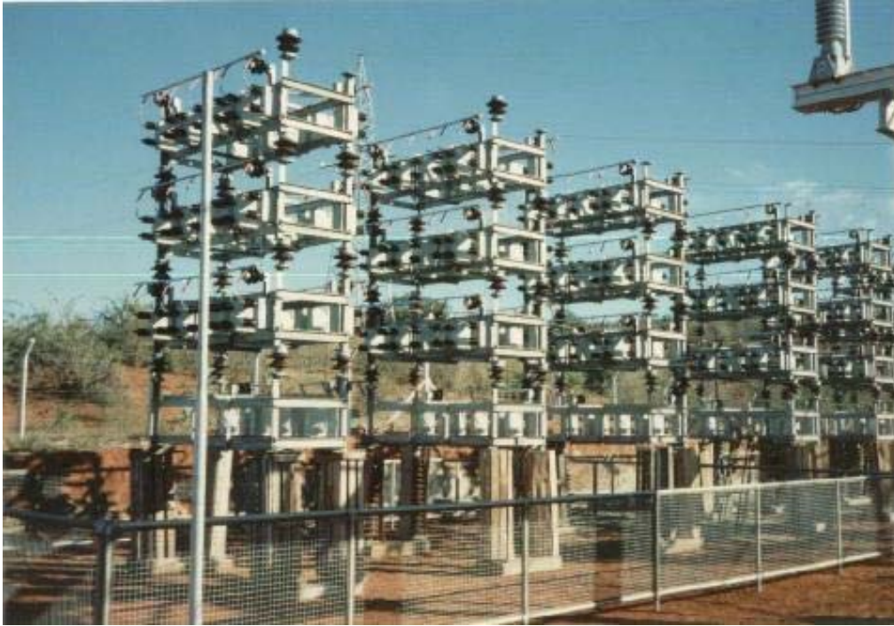
Figura 8b. Banco de capacitores para corregir el factor de potencia para una industria.
