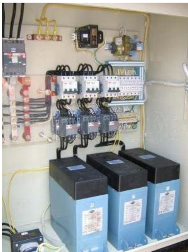
Figura 6b. Sistemas de corrección del factor de potencia para baja tensión por medio de capacitores.
