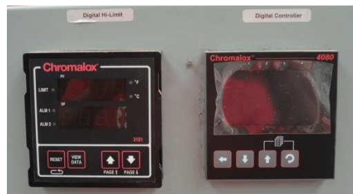
Figura 2.13 Panel de control del Calentador auxiliar.
