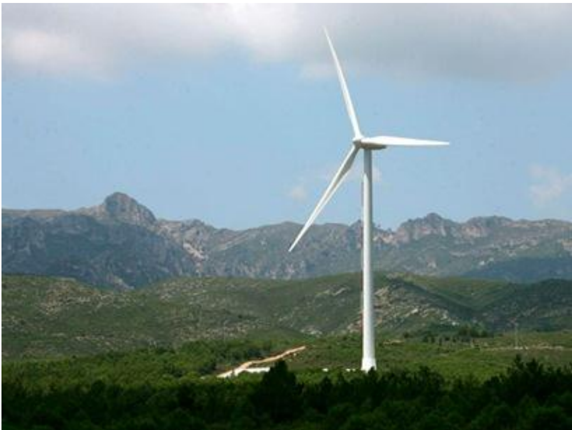
Figura 3.1 Aerogenerador ECO 100 de la empresa Alstom, instalado en el parque eólico de La Collada, en El Perelló, Tarragona, España. Posee la capacidad de generar 3 MW, la cual es suficiente para proporcionar energía a unas ocho mil familias.
