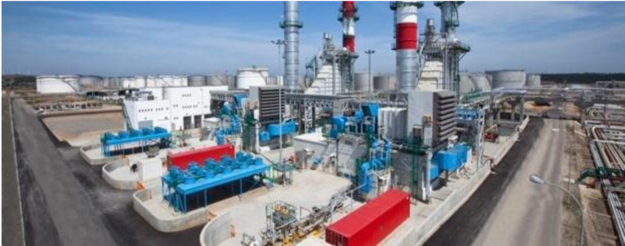
Figura 1.9 La planta más grande de cogeneración a gas natural en Portugal, en funcionamiento desde el año 2009.
