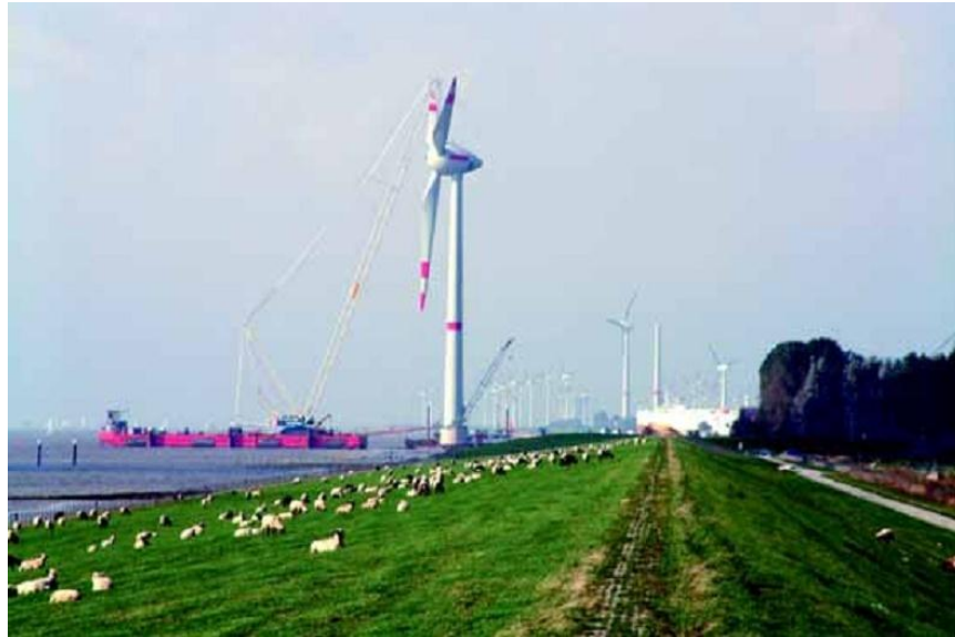
Figura 3.13 Enercon E-112 de 6 MW.
