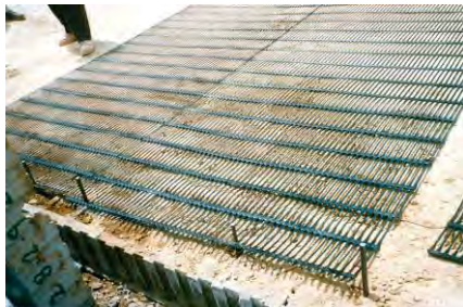
Detalle de fijación de malla tendida en huecos de block rellenos con grava que funciona como filtro.
