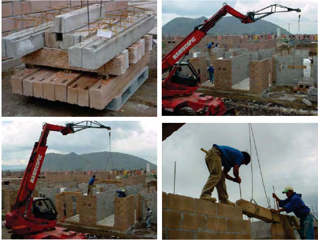
Figura A.105 – COLOCACIÓN DE DINTELES PRECOLADOS SUMINISTRADOS EN KITS (de 3 horas por proceso manual a 40 minutos con proceso mecanizado)
