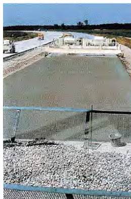
Figura B.642 – TENDIDO DE GRAVA en pavimento clavado Fuente: Voiries et Aménagements Urbains en Béton Tome-2, Mise en Oeuvre, T-51 CIMBÉTON-1996; p. 71.
