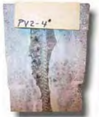
1) CORTE DE MURO POR CASTILLO AHOGADO MOSTRANDO UNA TÉCNICA INADECUADA DE CONSOLIDACIÓN DEL CONCRETO DE RELLENO
