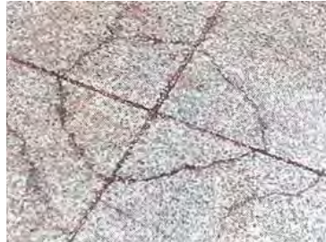
Figura B.796 – RIESGO DE FISURACIÓN EN ESQUINAS DE TABLEROS DE SOBRECAPAS DE CONCRETO (Ultra White Topping)
