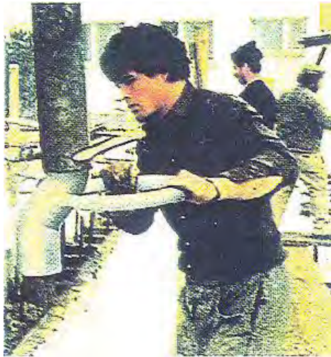
Figura A.172 - Dispositivo conveniente para vaciado de concreto en huecos de muros de mampostería
