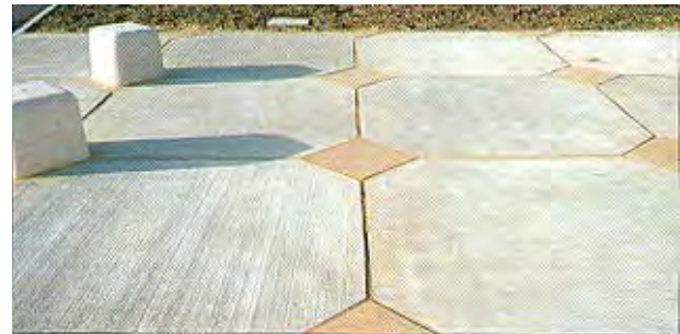
Figura B.647b – LOSAS GRANDES de 14 cm de espesor con losas en esquina a 45°
