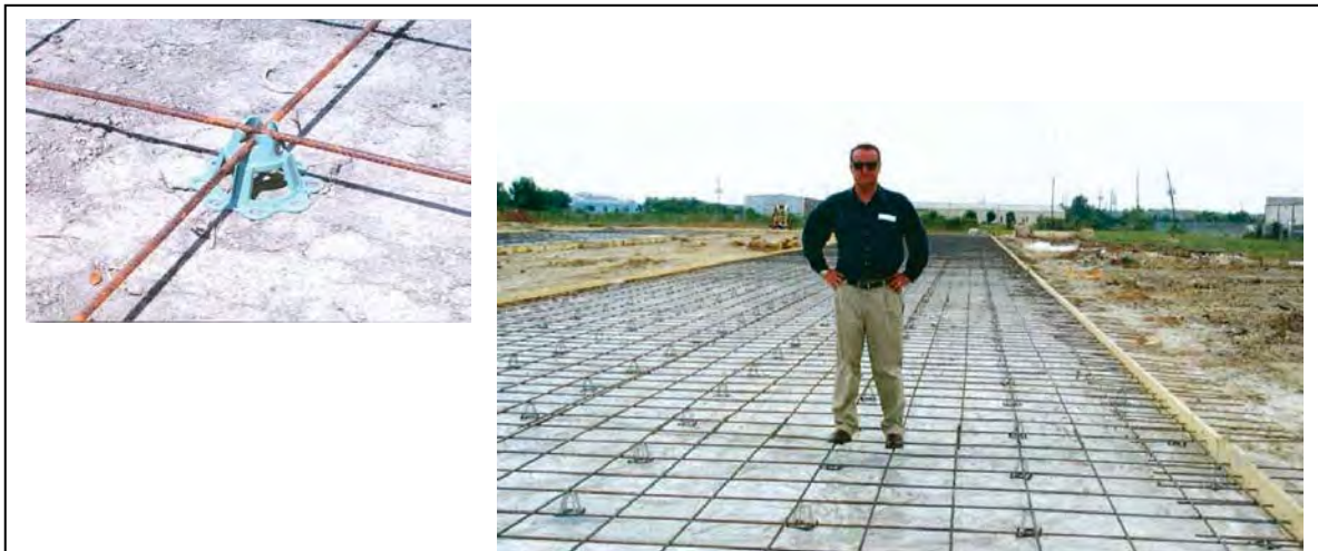
Figura B.67 – POSICIÓN FIJA E INDEFORMABILIDAD DEL ACERO ante cargas verticales empleando silletas resistentes a distancias convenientes Ref. Catálogo Publicitario de GTI General Technologies, Inc.
