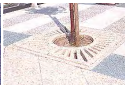
REJA DE CONCRETO PRECORADO. El tutor se ubica en el centro al lado del árbol
