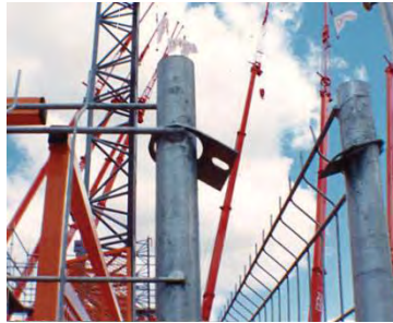
Figura A.100c – DETALLES DE UNIÓN DE BARDAS para obra, en esquinas en la parte alta. Se utilizan placas y broches de fijación
