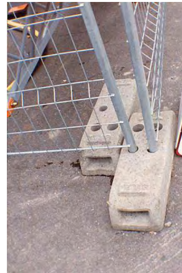
Figura A.100d – DETALLE DE UNIÓN DE BARDAS para obra en su parte baja. Se utilizan piezas prefabricadas cuyo diseño cubre el requisito de apoyo
