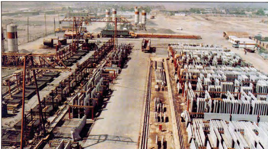
Figura A.96 – EJEMPLO DE INSTALACIONES CLAVE EN OBRA (Al frente: Zona de prefabricación de paneles de muros y losas) (Al fondo: Plantas de concreto premezclado) - Folleto publicitario de la Empresa OUTINORD
