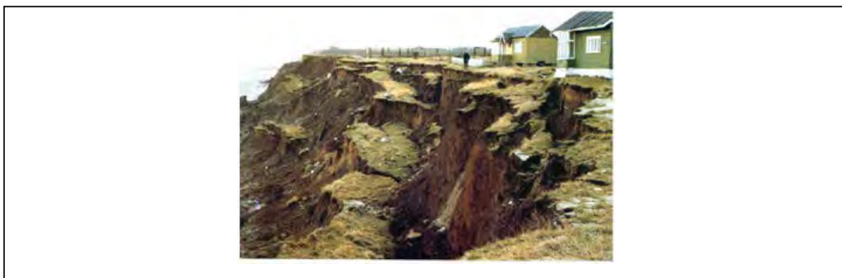
Figura B.4 – FALLA DE LADERA PRÓXIMA A UN PROYECTO DE VIVIENDA de poca altura que denota una falta de análisis previo de las condiciones del terreno desde el punto de vista topográfico y geotécnico. Fuente: BRE Digest 348 Diciembre 1999.
