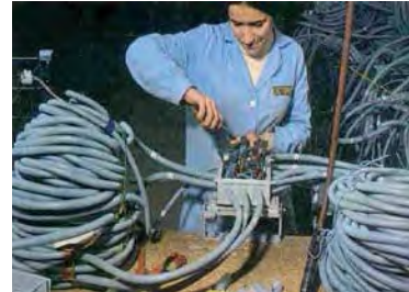
Conexión a tableros
