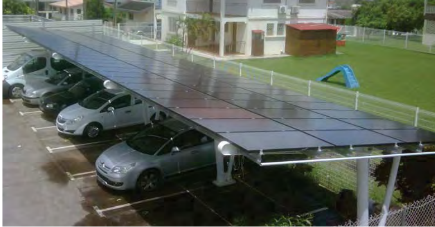
Figura C.47 – CUBIERTA SOBRE ÁREA DE ESTACIONAMIENTO DE VEHÍCULOS FORMADA POR PANELES MODULARES DE CELDAS FOTOVOLTAICAS para la transformación de energía solar en energía eléctrica - Fuente: Folleto de patrocinadores de France Green Tech, México 2012, empresa SOLAR ELECTRIC; p. 18
