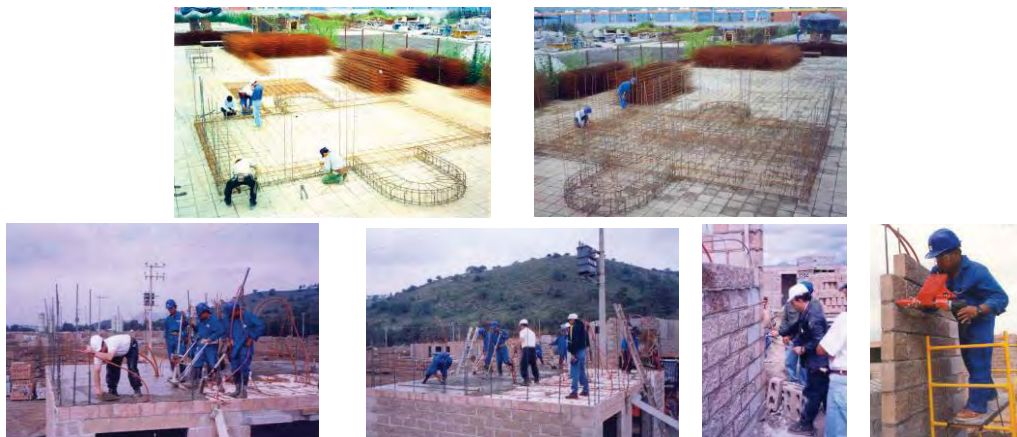
Figura 3.46d – CURSOS FORMALIZADOS DE CAPACITACIÓN EN CASAS GEO organizados con la participación de enseñantes de “Les Compagnons du Devoir” de Francia para albañilería (concretos, mamposterías y obras complementarias). Fuente: Fotografías tomadas directamente en Obra de Ixtapaluca 2000, construida por Geo Edificaciones, S.A. de C.V.
