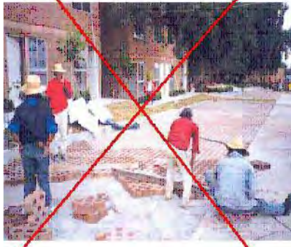
Figura A.177a – PROCESO INCORRECTO DE COLOCACIÓN DE ADOPASTOS - En esta fotografía los trabajadores están pisoteando la cama de arena haciendo difícil e inestable la nivelación de la obra terminada.
