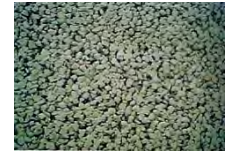
Figura B.757 APARIENCIA DE SUPERFICIE DE UN CONCRETO DRENANTE Fuente: T.57, CIMBÉTON; p. 134
