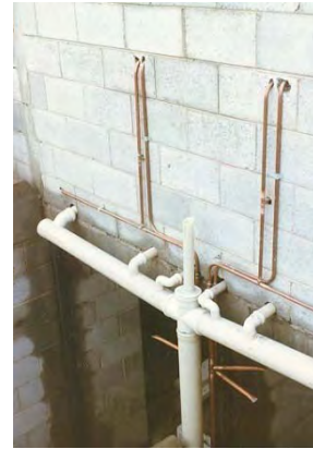
Figura B.250 – TUBERÍA PREFABRICADA colada en patio de servicio de una vivienda económica
