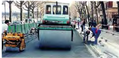
Figura B.754 - COMPACTACIÓN DE UN PAVIMENTO DE CONCRETO DRENANTE Fuente: T-57 CIMBÉTON; p. 31
