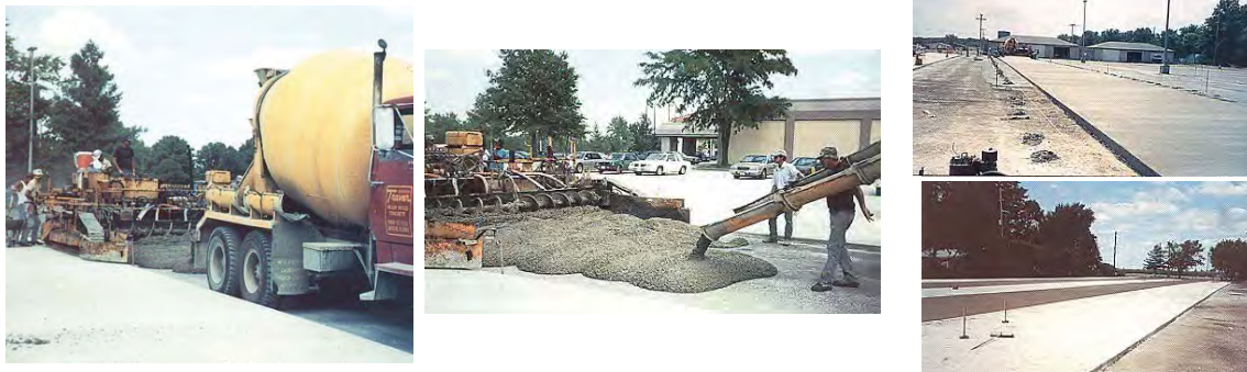
Figura B.782 – PROCESO DE EJECUCIÓN MECANIZADA DE SOBRECAPAS DE CONCRETO SOBRE PAVIMENTOS DE ASFALTO degradados a través del tiempo.
