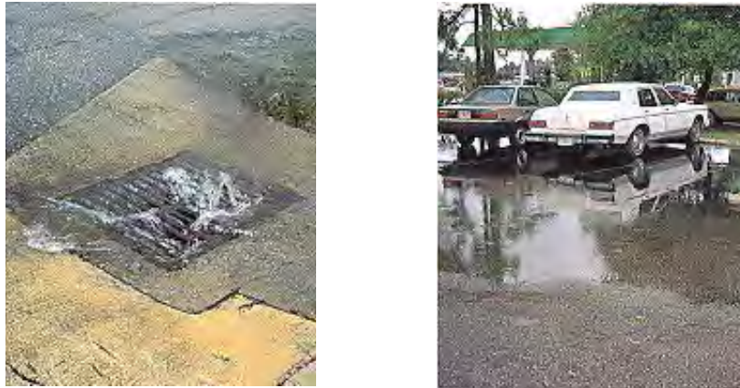
Figura B.741 –TAPAZONES EN LAS COLADERAS Y ENCHARCAMIENTOS EN LAS ÁREAS PAVIMENTADAS. Los hemos visto hasta ahora con resignación y naturalidad sin estar conscientes que sólo son signos externos de una importante desecación del subsuelo que tiende a desaparecer los mantos acuíferos.
