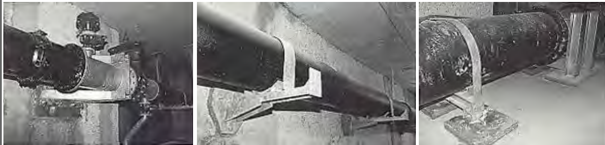
Figura B.518b.- Para evitar perforaciones a las paredes de la galería técnica y conservar su estanqueidad, los apoyos de las tuberías van adheridos con un pegamento químico resistente a los golpes de ariete y a las vibraciones de la tubería - Ref. SEMAPA, Le Moniteur 2 de diciembre 1994 ; p. 65
