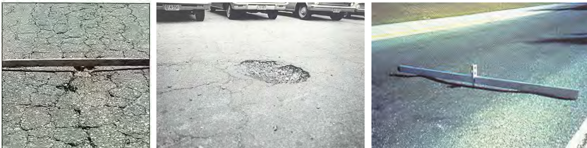
Figura B.778 – PATOLOGÍAS MÁS COMUNES DADAS EN LOS PAVIMENTOS DE ASFALTO. Deben investigarse todas las probables razones de deterioro de los pavimentos existentes y, seguidamente, deberán corregirse y/o considerarse en el diseño de la nueva capa de concreto
