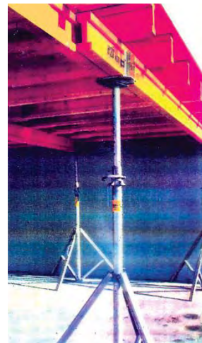
Figura A.158d – EMPLEO DE PUNTALES Y LARGUEROS DOKA PARA CIMBRA DE LOSA MACIZA
