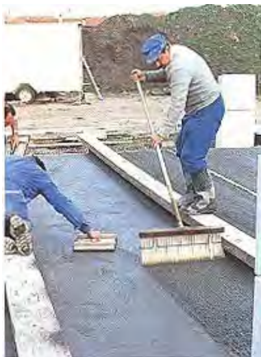
Figura B.799 – ESTRIADO CON CEPILLO para evitar el deslizamiento de los autos al frenar y los resbalones y caídas de los peatones en época de lluvia Fuente: Le Béton de Ciment Mince Collé "BCMC" – T-60 CIBBETON, Francia ; p. 7
