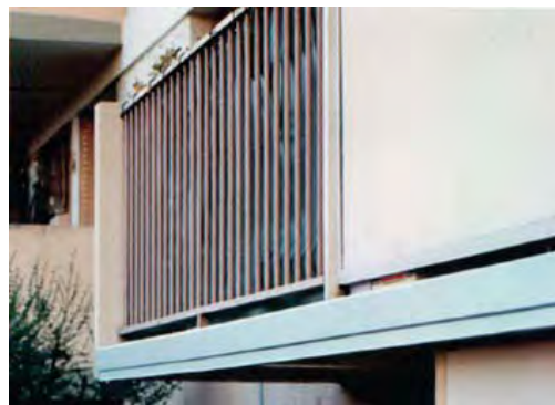
Figura B.466b - Borde de losa de balcón protegido con moldura y gotero de aluminio laqueado u otro material durable
