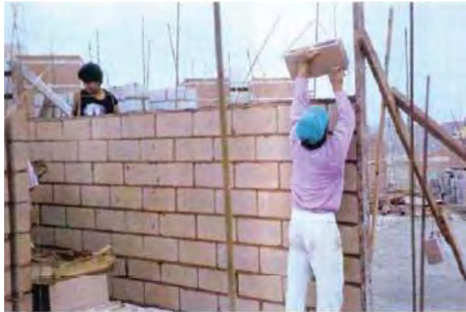
Figura A.140 – COLOCACIÓN DE MAMPOSTERÍA SIN MEDIOS ADECUADOS
