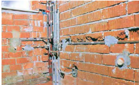
Figura B.242a – TRABAJO TRADICIONAL DE INSTALACIONES CON RANURADO DE MUROS donde se aprecia la falta de limpieza y claridad del proceso así como el debilitamiento de la obra de albañilería.
