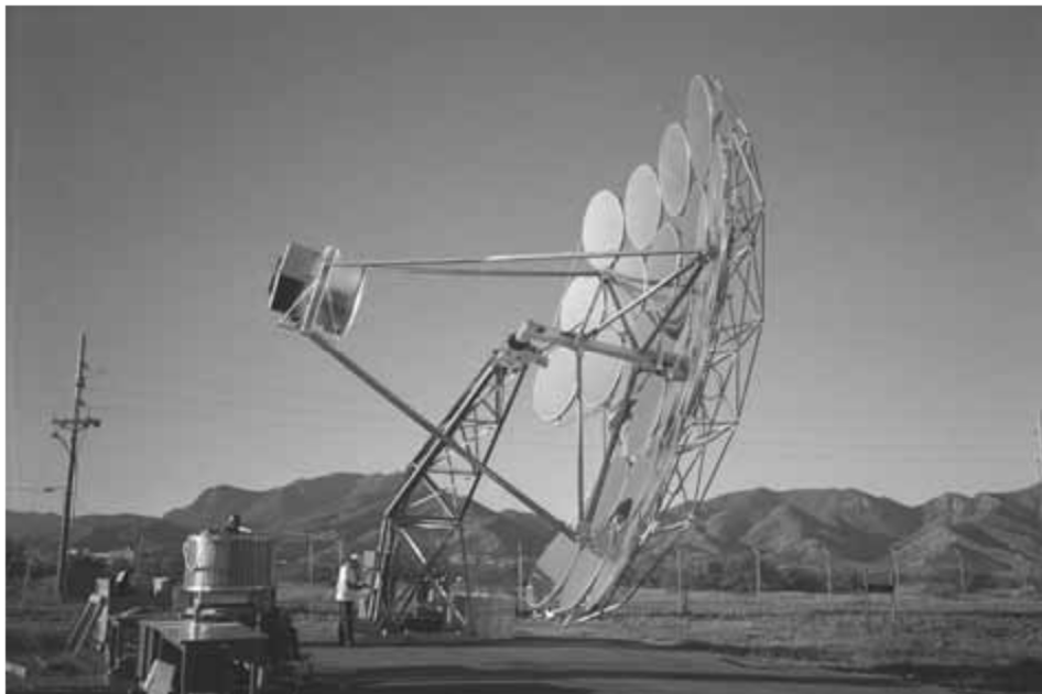
Imagen 3.5 Concentrador Cummins Power Generation CPG-460 con multifacetos de membranas tensionadas, (obtenido Lovegrove and Staine, 2012, pag 319).
