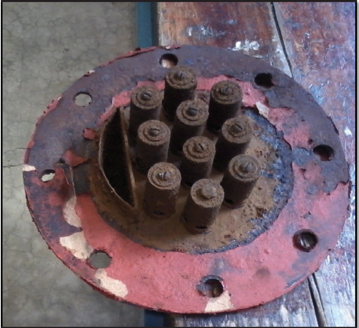
FOTO No. 2 MUESTRA ARREGLO DE CAMPANAS DE BORBOTEO
