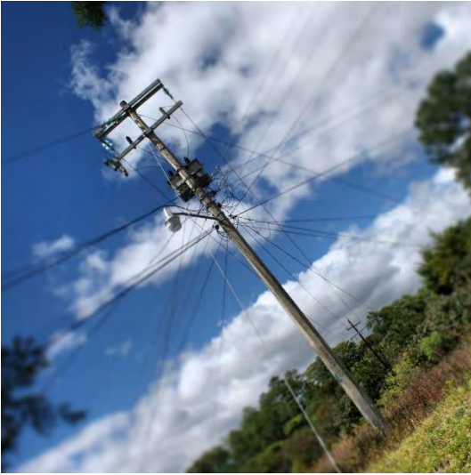
Fotografía 5: Transformador de luz. Fuente: Propia 2013.
