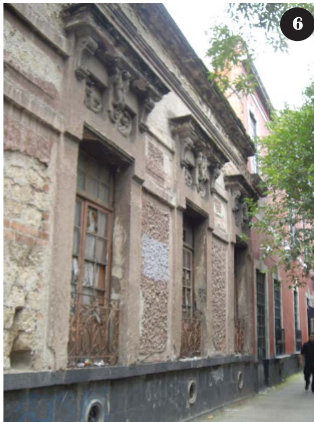
La imagen de arriba (6) corresponde a las jambas y balcones formados por estas mismas en la Fachada de Díaz Mirón 80, se observa el desprendimiento de aplados y algunos sillares de tepetate, la herrería original aún se conserva. La imagen de la izquierda (7), es tomada desde la azotea de la primer crujía, nótese el contraste de lo conservado de la fachada con lo prácticamente extinto al interior del predio.
