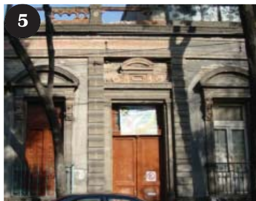
5 Inmueble de uso original para vivienda, y adaptado para colegio, en la calle de Jaime Torres Bodet.
