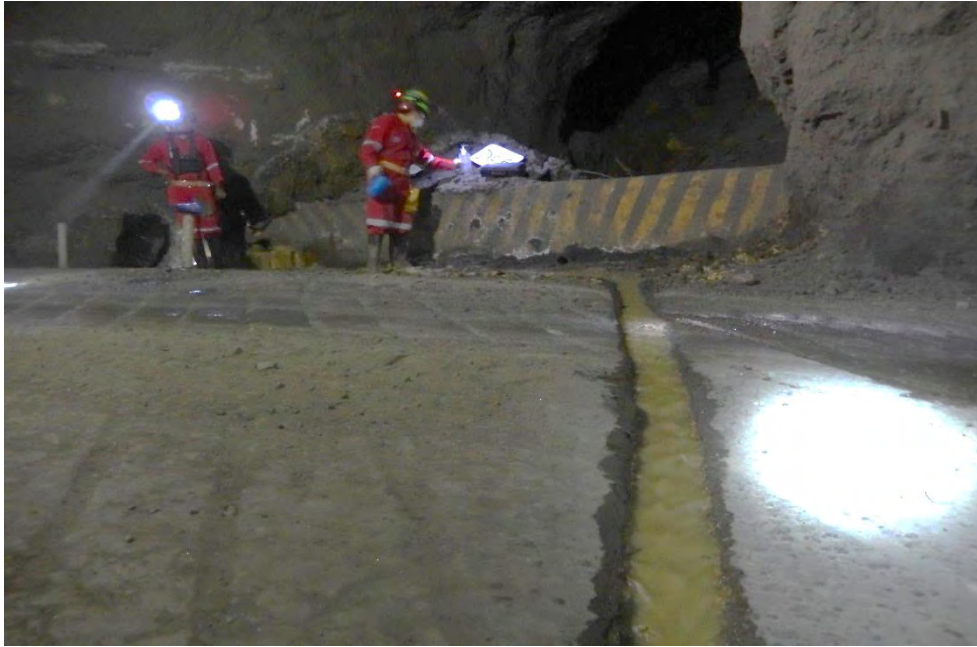
Figura 42. El agua que se desborda por el muro de concreto, es canalizada mediante una acequia que cruza la rampa para de manera posterior incorporarse a la acequia principal.
