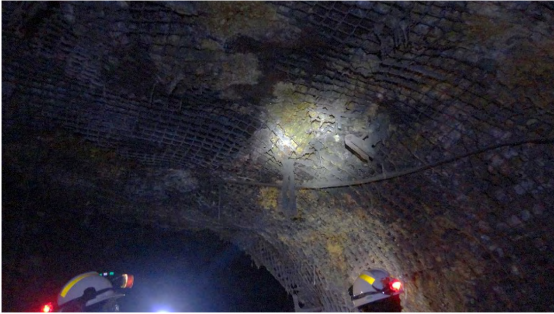
Figura 27. Malla ciclónica presentando corrosión por el DAM
