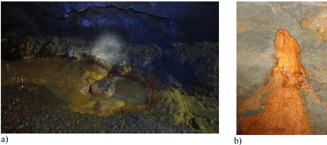
Figura 26. a) Coloración amarilla sobre la rampa Sur. b) Oxidación de la roca presentando una coloración rojiza.
