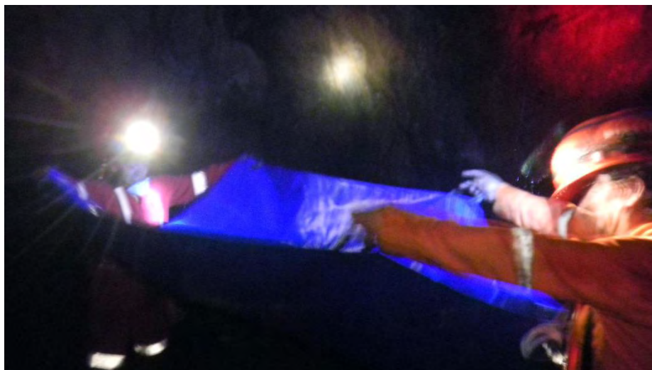
Figura 56. Uso de la lona como medio para captar los escurrimientos del cielo de las obras y contrapozos.
