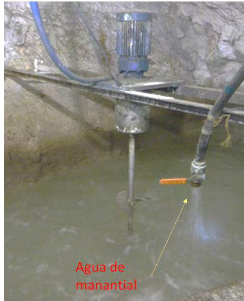
Figura 49. Pileta de mezclado. Planta de tratamiento
