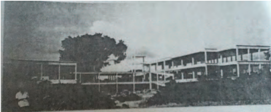
Hospital General, Tapachula, Chiapas (1942) durante su construcción. Fuente: Archivo histórico de la SSA, en las Memoria de 1942-1943, Informe de Labores, México, Secretaría de Asistencia Pública.
