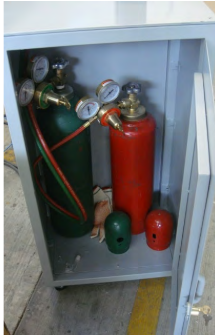
Figura B.12 Compartimiento para los tanques que usará el soplete.
