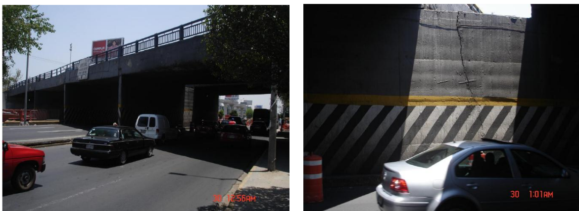
Figura 2.38 Daños causados por las grietas “Echegaray” y “La Florida” (Santana, 2008)
