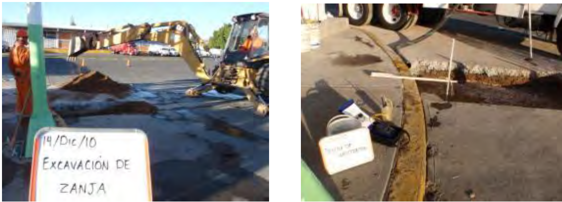
Figura 33. Foto izquierda: Realización de trabajos de excavación. Foto derecha: Monitoreo de conductividad eléctrica en zanja con columna de agua durante la realización de la prueba.
