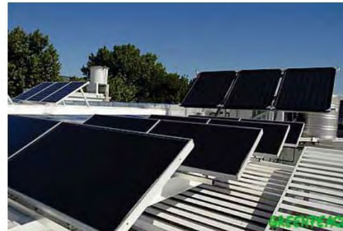
Img. 13 Paneles Solares.
