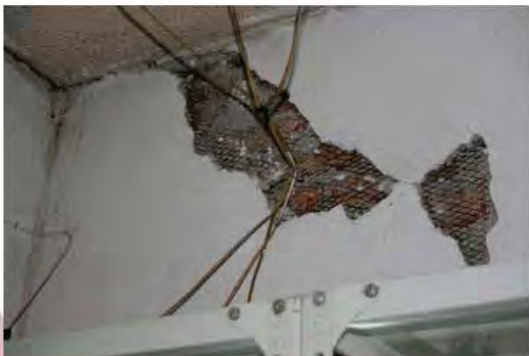
Img. 3 Deterioro de acabados
