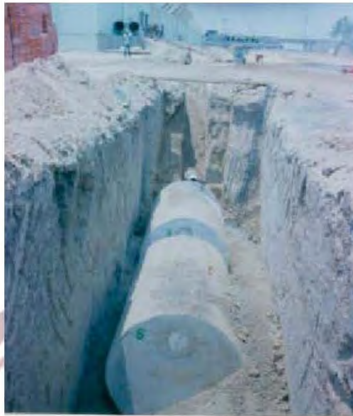
Img. 11 Filtros sanitarios.
