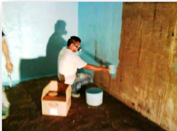
Figura. 3.4. Cisterna del Centro Tecnológico
