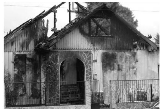
Fig. 6. Fotografía de una casa incendiada.
