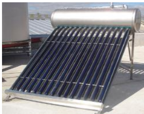
Imagen 13. Sistema de calentamiento solar de agua
