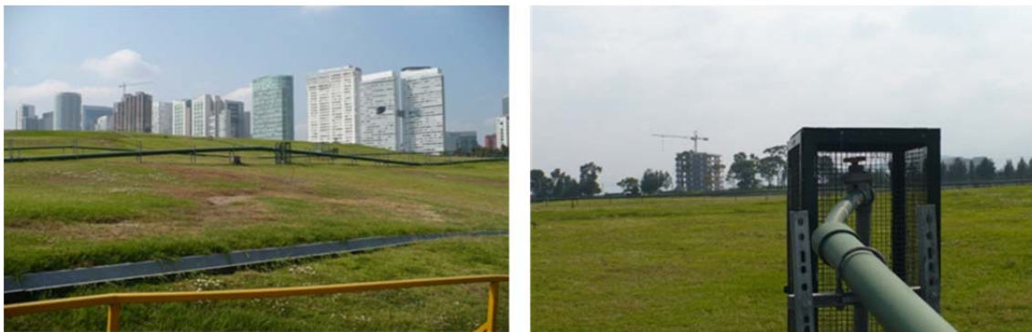
Fotografía 40: Red de captación de biogás del relleno sanitario Prados de la Montaña
