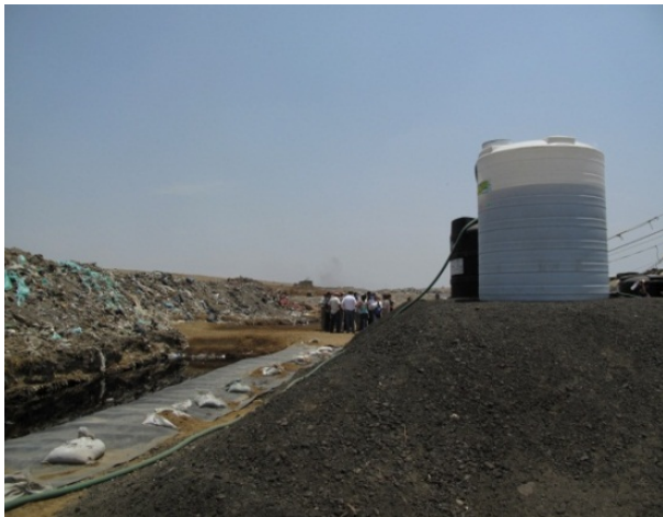
Fotografía 20: Planta móvil de tratamiento de lixiviados
