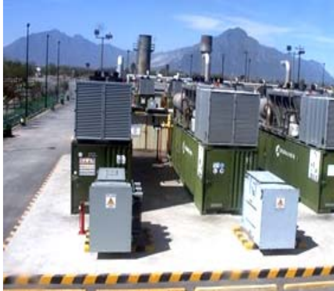
Fotografía 9: Producción de electricidad con biogás del relleno sanitario en Monterrey
