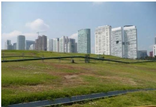
Fotografía 8: Sistema de captación de gases
