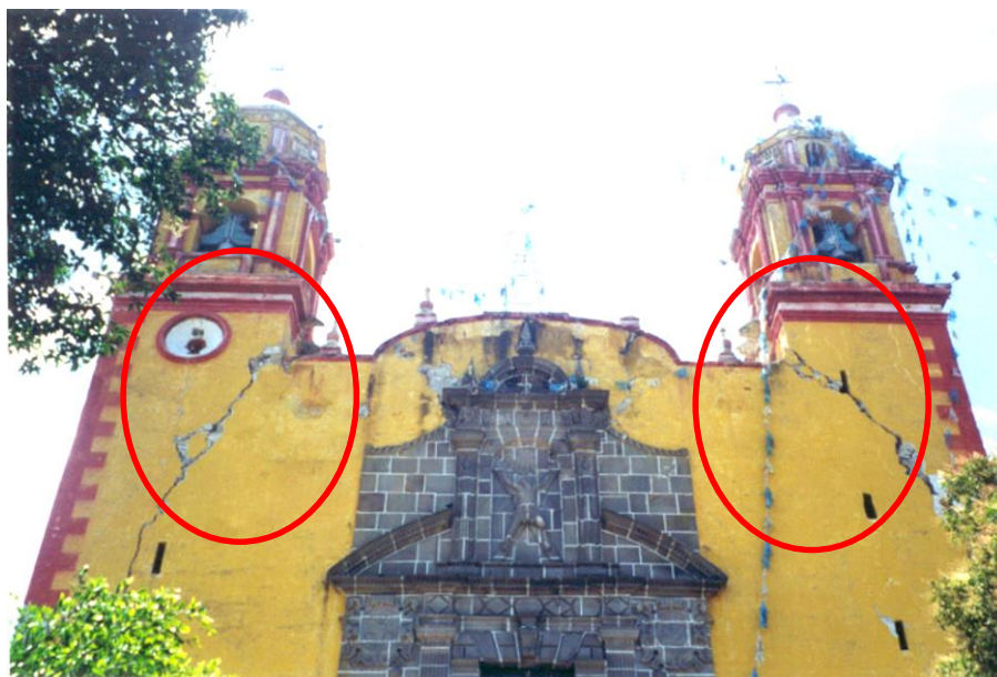
Figura 5.12 Agrietamientos por cortante y tendencia al desprendimiento de la torre con respecto de la fachada (Rangel, Vázquez y Cabrera, 2004)
