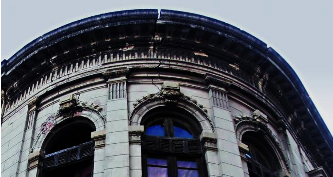
Figura 3.1 Grietas verticales en el muro, generados por concentraciones de esfuerzos en los apoyos de la cubierta (Rivera, 2009)
