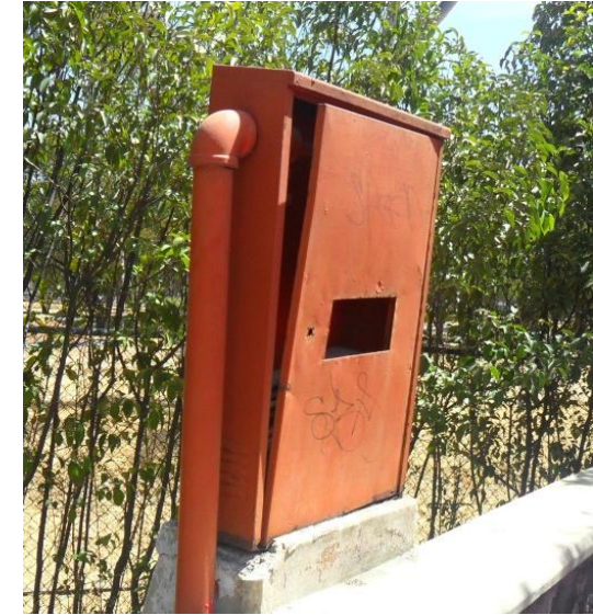
Manguera contra incendios
