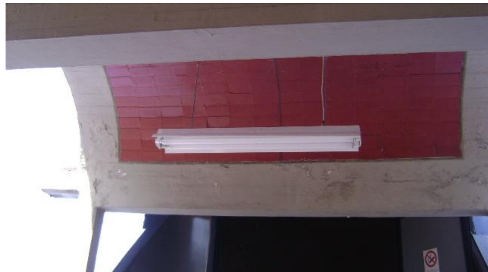
Luminarias y cubierta en mal estado
