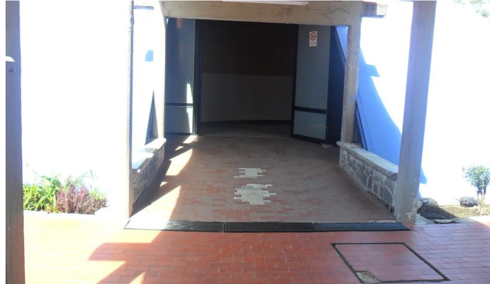
Obstrucción de acceso a sala por registro y rejillas en el piso
