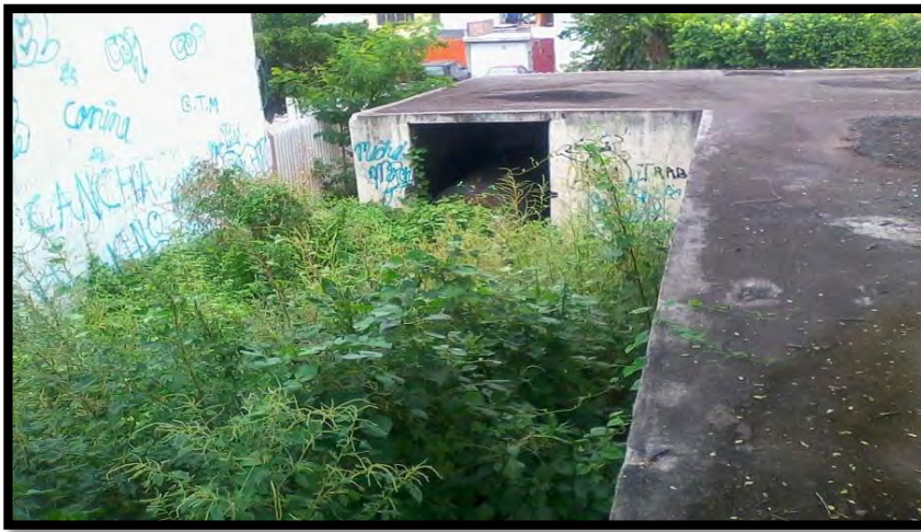
Imagen 3.9.3. Cuarto de bombeo
