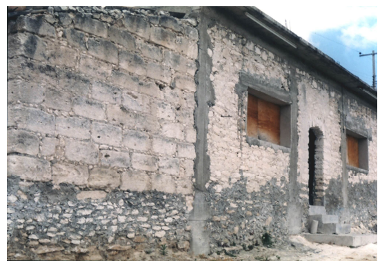
Vivienda híbrida: muros de piedra cortada con cerramientos p/ ventana; columnas de "refuerzo" y loza de concreto armado.
