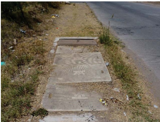
REGISTROS DE TELMEX. CERCANO AL PREDIO EXISTEN SOBRE EL BOULEVARD, REGISTROS DE TELMEX, MISMOS QUE PUEDEN SER UTILIZADOS PARA EL FUTURO HOSPITAL, DICHS REGISTROS ESTÁN A 300 ML APROX.
