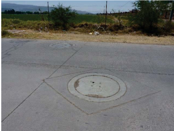
SISTEMA DE DRENAJE. UBICADO A LAS AFUERAS DEL FRACCIONAMIENTO SOBRE EL BOULEVARD.
