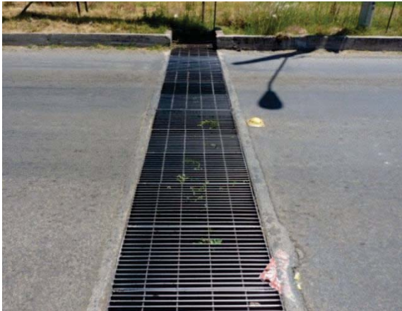
SISTEMA DE REJILLAS DE AGUA PLUVIAL. UBICADAS SOBRE EL BOULEVARD.
