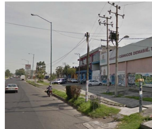
Imagen35.- Tendido telefónico en Av. Guelatao.
