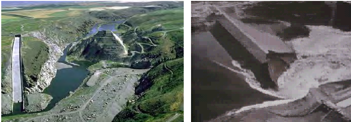
Figura 1.40 Falla en la presa Teton en la imagen de la derecha se aprecia el momento de la falla. http://fluidos.eia.edu.co/presas/tipos_presa/marcos/presa%20de%20terraplen/m_Teton_terraplen.htm
