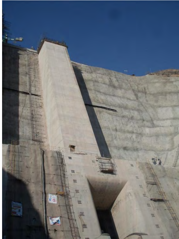
Figura 1.17 Se aprecia una de las dos obras de toma que fueron construidas en el C. H. La Yesca. En la foto están todavía en proceso de construcción. (Fuente Propia)
