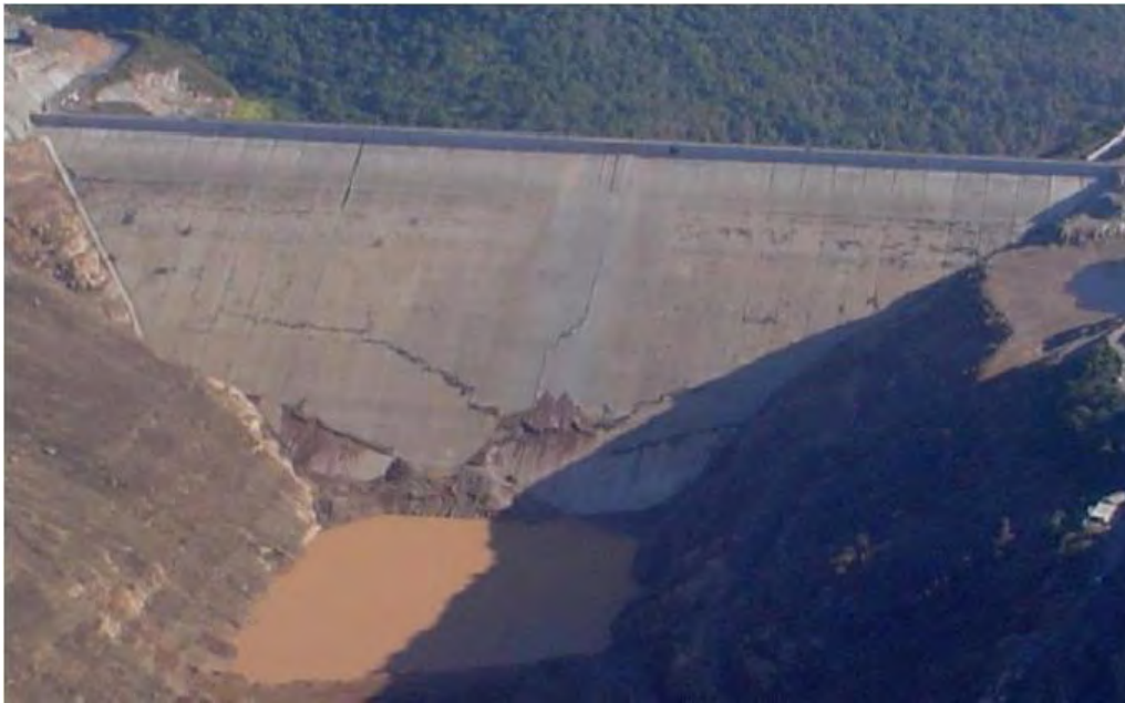
Figura 1.43 Falla de la presa Campos Novos se puede apreciar la fractura en la pantalla de concreto. (Marengo, 2011)
