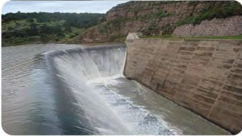
Figura 1.31 Canal Colector de un vertedor de canal lateral; vista hacia aguas arriba de la presa.
