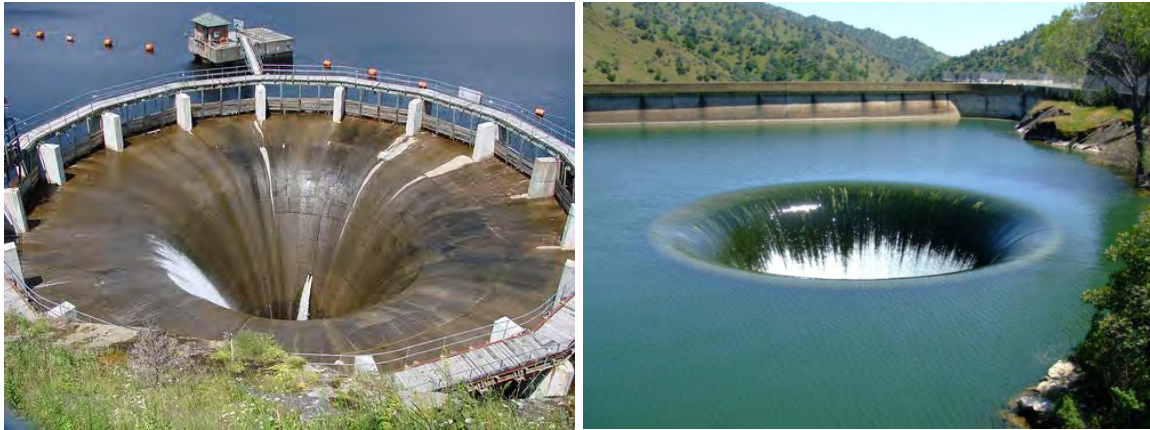
Figura 1.26 Vertedor de embudo de la presa Monticello en California, conocido también como “Glory Hole”. (Murillo, 2012)
