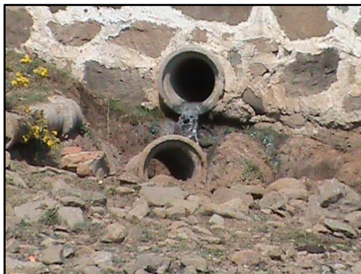
Figura 3.5 Descarga de agua residual en el embalse de la presa Villa Victoria.
