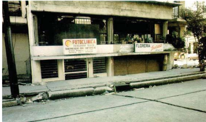
Figura 4.6 Asentamiento del Edificio
