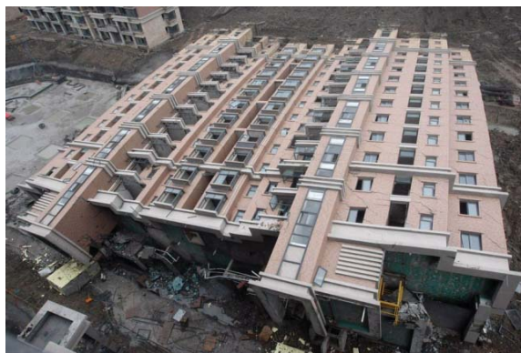
Figura 4.4 Edificio Después de la Falla
