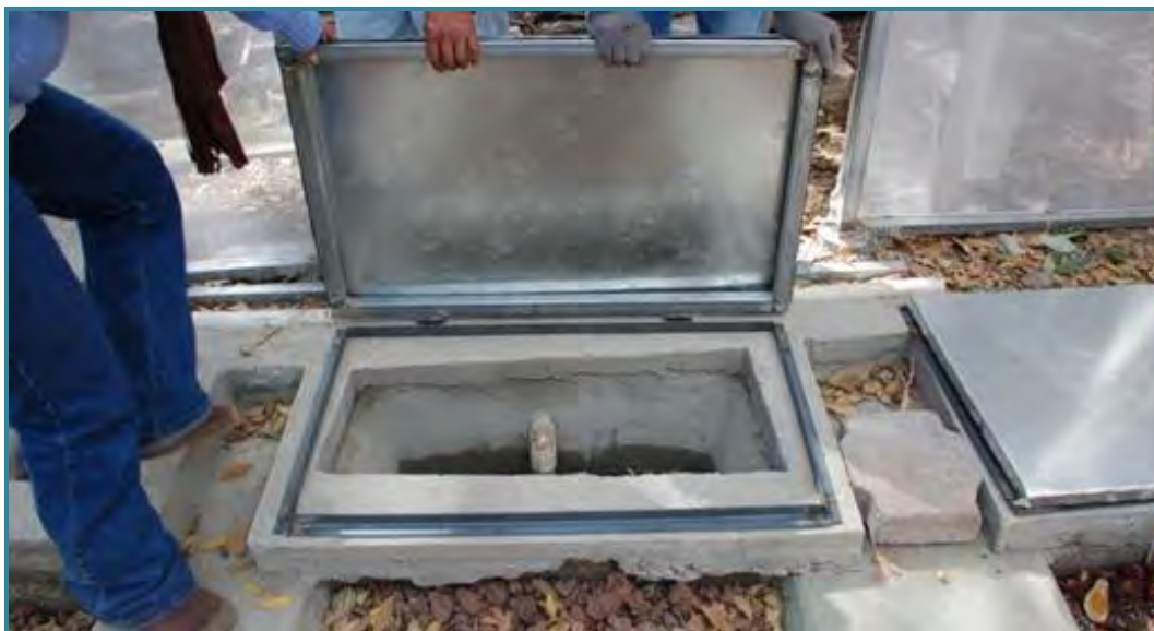
FOTO 20. TAPAS DE LOS DEPÓSITOS DE SALIDA.
