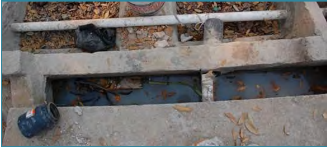
FOTO 11. CAMBIÓ DE TUBERÍA DE ENTRADA DE AGUAS NEGRAS A DEPÓSITO DE ENTRADA PARA MEJORAR EL FLUJO DE ESTAS DENTRO DEL SISTEMA
