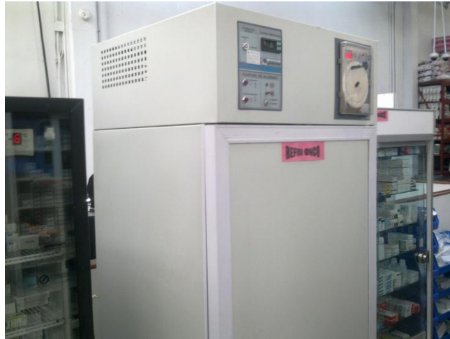
Figura 2.3. Equipo de refrigeración.
