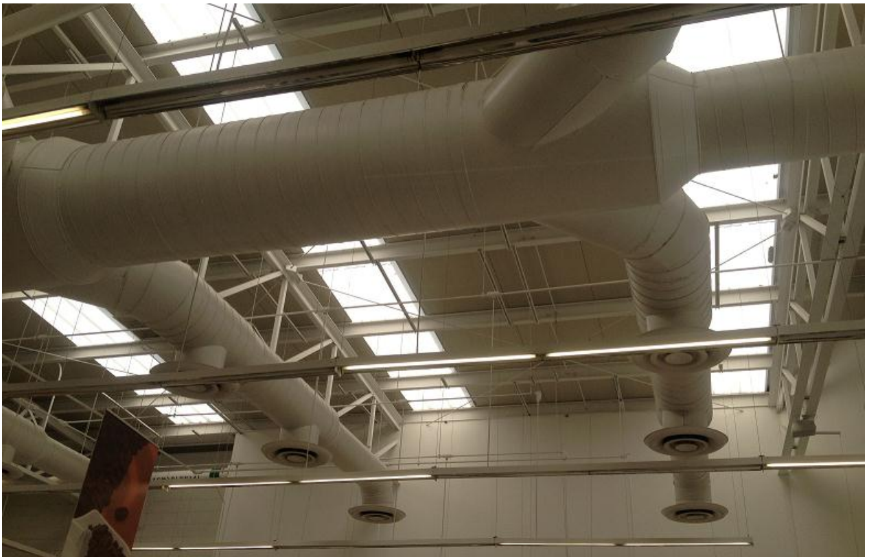
Figura 2.1. Techumbre, ductos de aire acondicionado y arreglos de lámparas fluorescentes.
