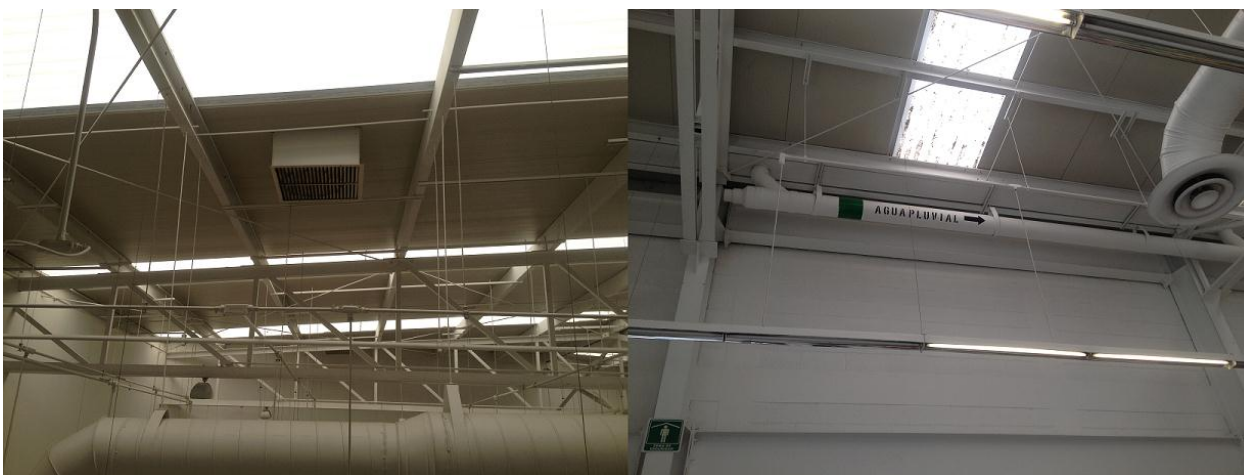
Figura 2.2. Extractores de aire y tubería para recolección de aguas pluviales.
