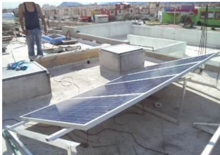
Figura 3.29 Módulos montados y conectados.
