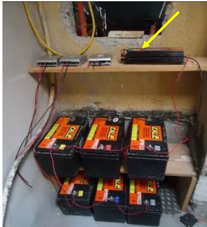
Figura 3.26 conexión del inversor.
