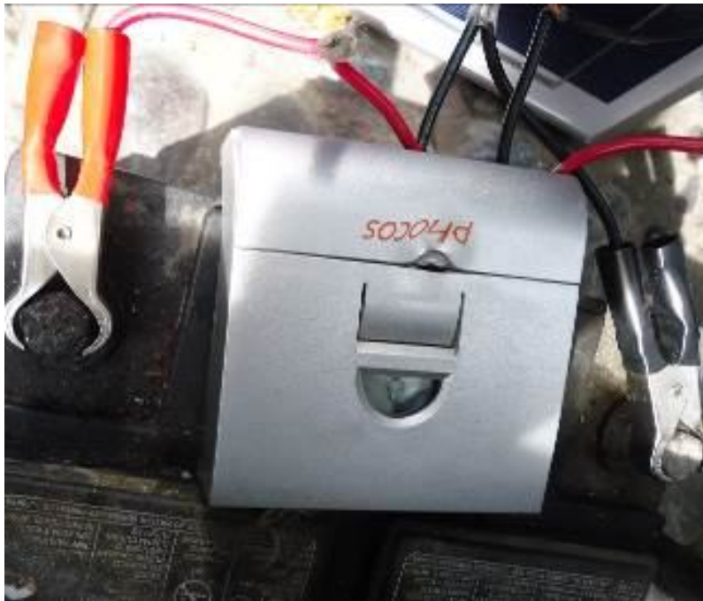
Figura 3.18 Control de carga para batería
