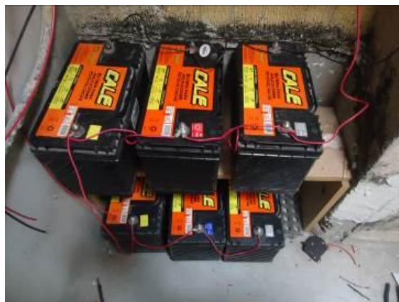
Figura 3.25 Conexión de baterías.
