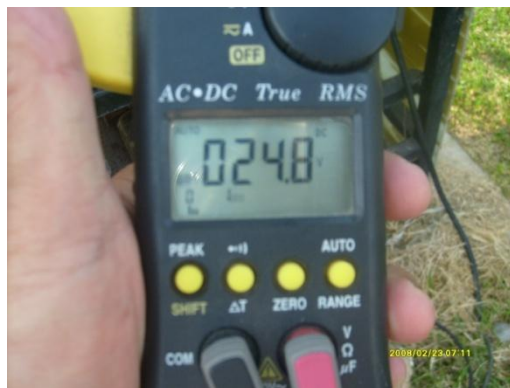
Figura 2.29 Medición tomada en el banco de baterías al realizar las pruebas.
