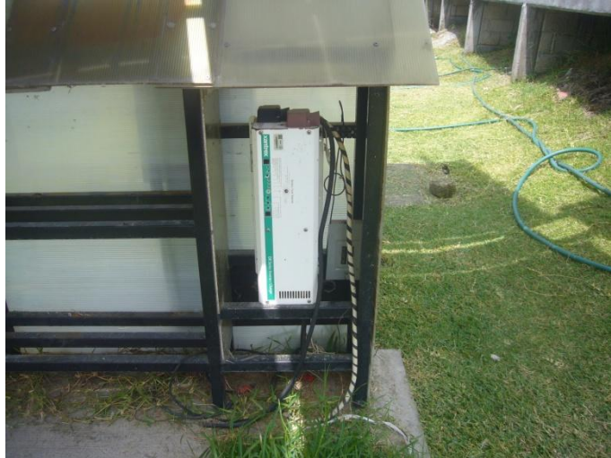
Figura 2.24 Caseta para el inversor.
