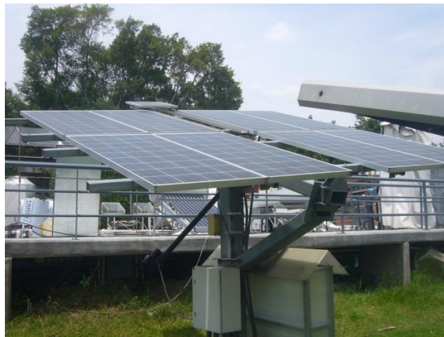
Figura 2.1 Arreglo fotovoltaico con seguidor del sol.
