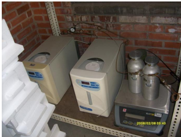
Figura 2.26 Generadores de hidrogeno que se encuentran dentro de la caseta y serán las cargas de nuestro sistema.
