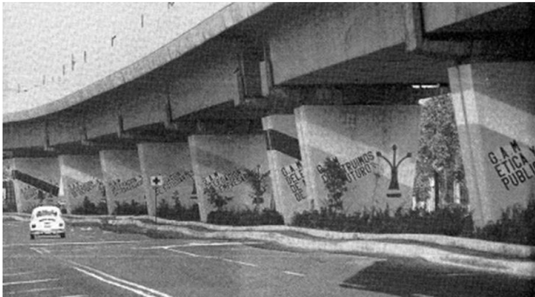
Ilustración 6.3 Vista de los asentamientos diferenciales sobre la Av. Congreso de la Unión, en el tramo Bondojito-Talismán.
