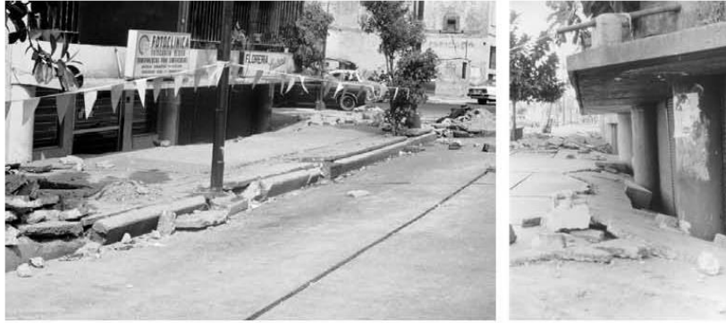
Foto 7 Falla local de la cimentación de un edificio en Ciudad de México en el sismo del 19 de septiembre de 1985. (Cortesía de Miguel Romo y Gabriel Auvinet)
