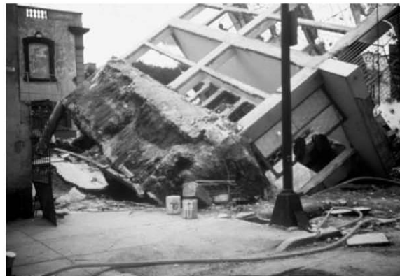
Foto 8 Falla general de la cimentación de un edificio en Ciudad de México en el sismo del 19 de septiembre de 1985 (cortesía de Miguel Romo)
