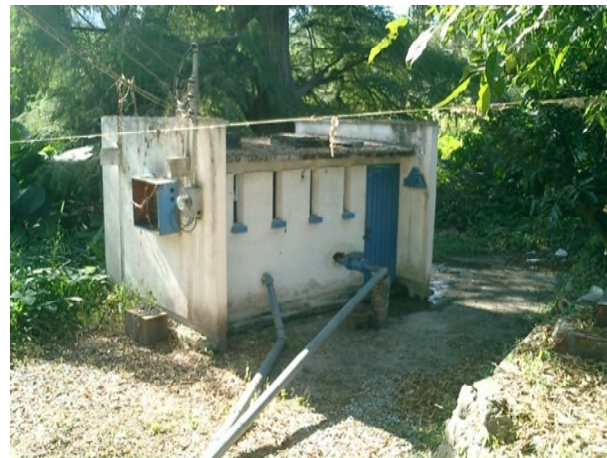
Imagen NO. 15. Caseta de bombas de extracción de agua.
