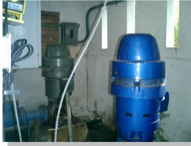
Imagen No. 16. Bombas de extracción de agua.
