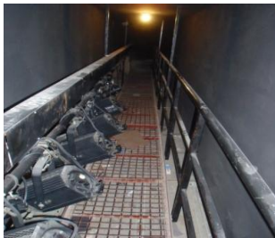
Vista interior de los puentes de iluminación del teatro del Centro de Extensión Universitario
