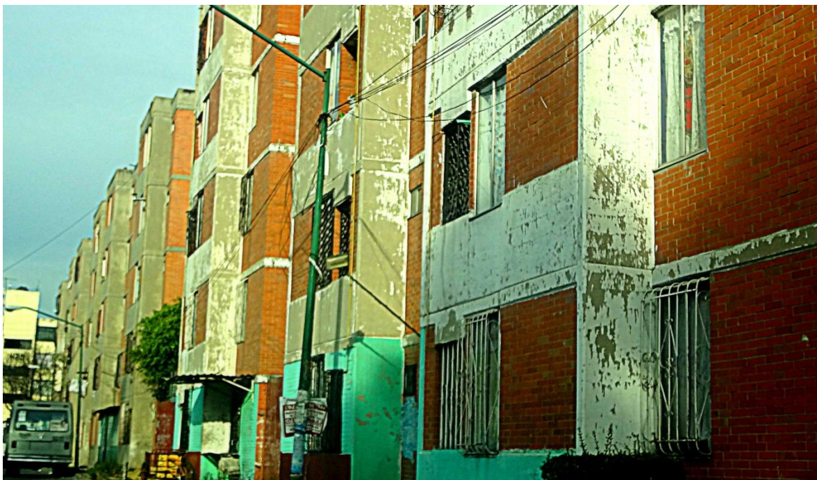
Descuido y falta de mantenimiento de los espacios comunes.
