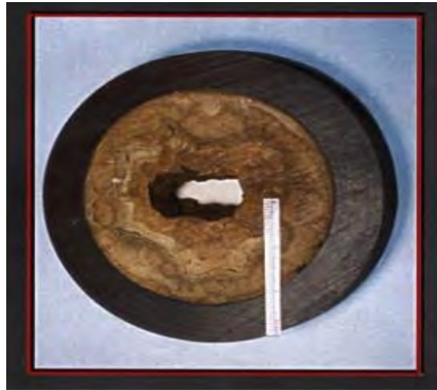
Figura 2.2 Sección transversal de una tubería con deposición de ceras.
