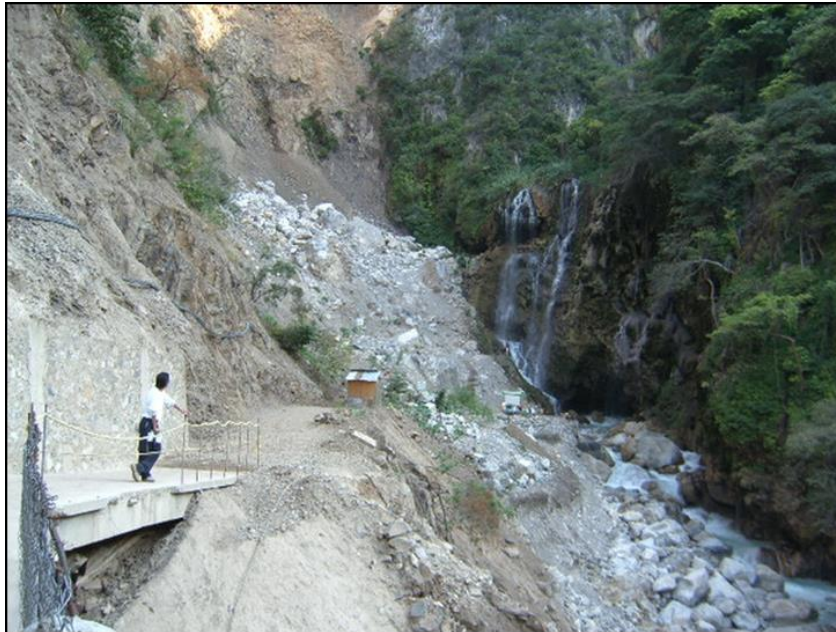
Imagen 6. Escarpes activos por procesos de remoción en masa de caída de escombros.
