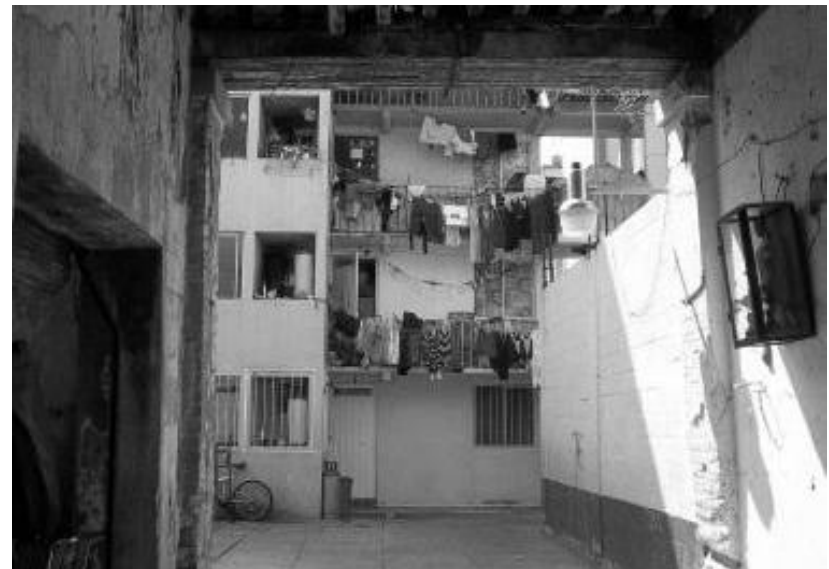
Imagen 45. Vecindad típica de la colonia. Muchas de ellas son edificios porfirianos en los cuales es evidente la falta de mantenimiento.
